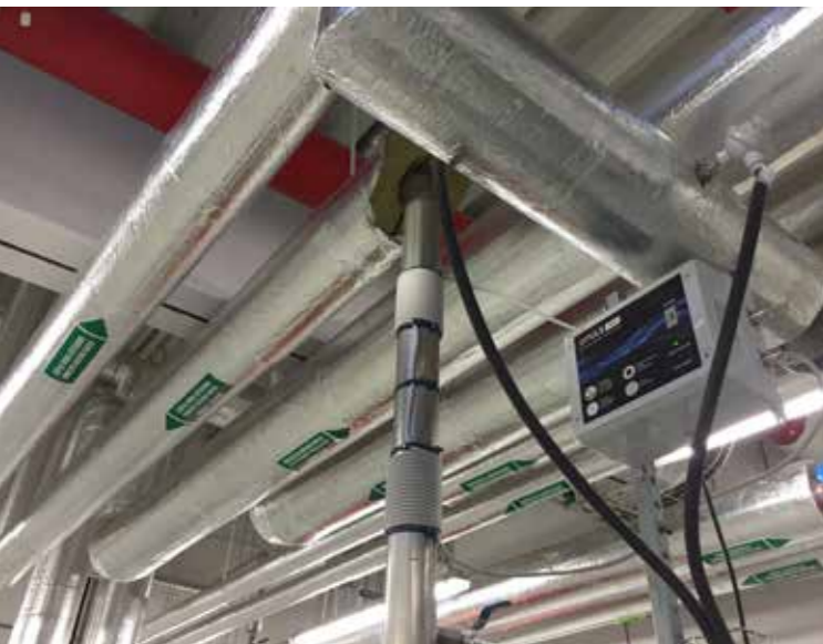
zabezpieczenie instalacji ciepłej wody użytkowej (CWU)
