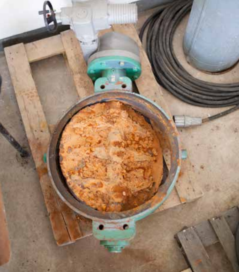
Zasuwy DN500 z napędem pneumatycznym. Odrywające się cząstki twardego kamienia uszkodziły okrąg dysku i spowodowały nieszczelność
