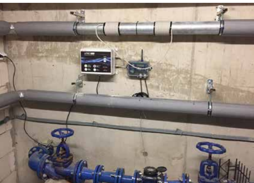
zabezpieczenie wody użytkowej w budynku wielorodzinnym
