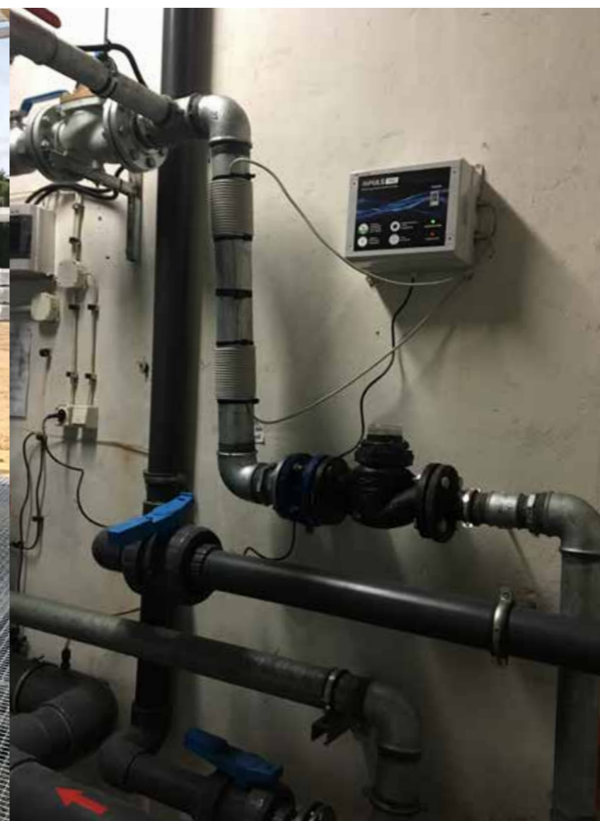
zabezpieczenie technologii wody w szkole oraz na basenie publicznym
