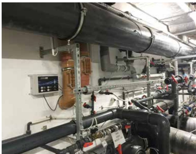
zabezpieczenie technologii wody na basenie publicznym
