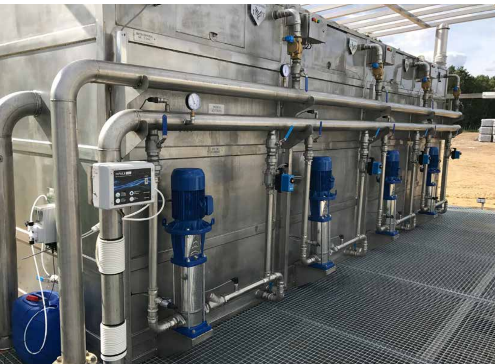
zabezpieczenie technologii w stacji uzdatniania wody
