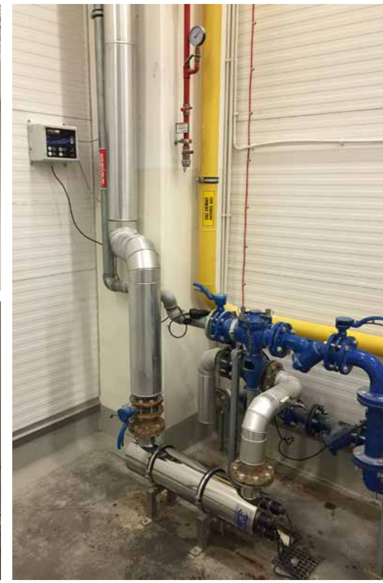
zabezpieczenie instalacji ciepłej wody użytkowej (CWU)
