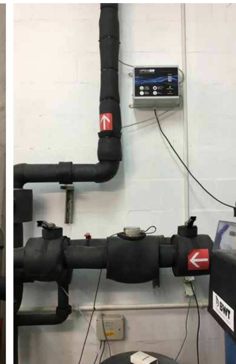
zabezpieczenie wody użytkowej w centrum handlowym
