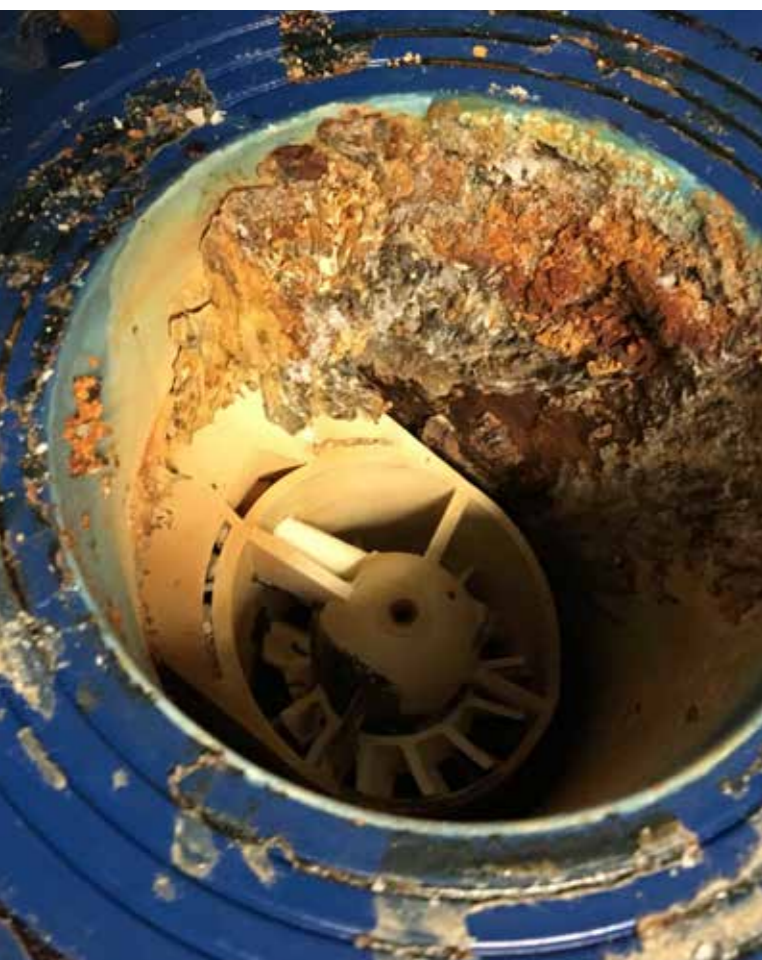
Uszkodzony licznik przepływu wody
